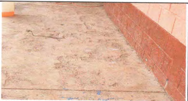
Foto 5: Sustitución de piso por grietas.
